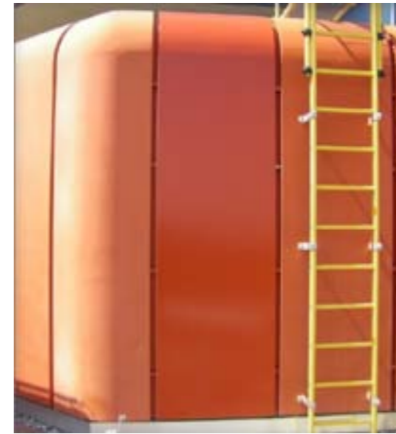
Bild 20: Metallfassade pulverbeschichtet, 15 Jahre nicht gereinigt mit Reinigungsmusterfläche
